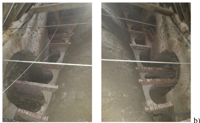
Рис. 4. Церковь Санта Каталина: вид в плане и разрез внешней поверхности свода с существующими (красные) и усиленными новыми ребрами жесткости (зеленые) (а); внешние поверхности свода после усиления (б).
