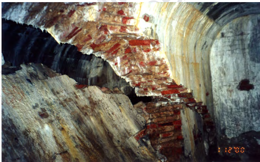
Поперечные стены подпорного сооружения, образующего террасу перед дворцом, были разрушены.
