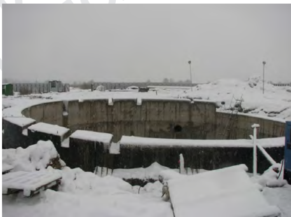
Опускной колодец канализационной насосной станции (вид после усиления сваями и появления крена до 1200 мм).
