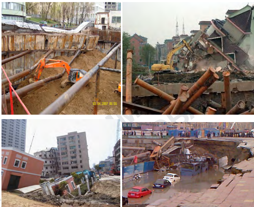
Примеры аварий котлованов в разных городах мира.
